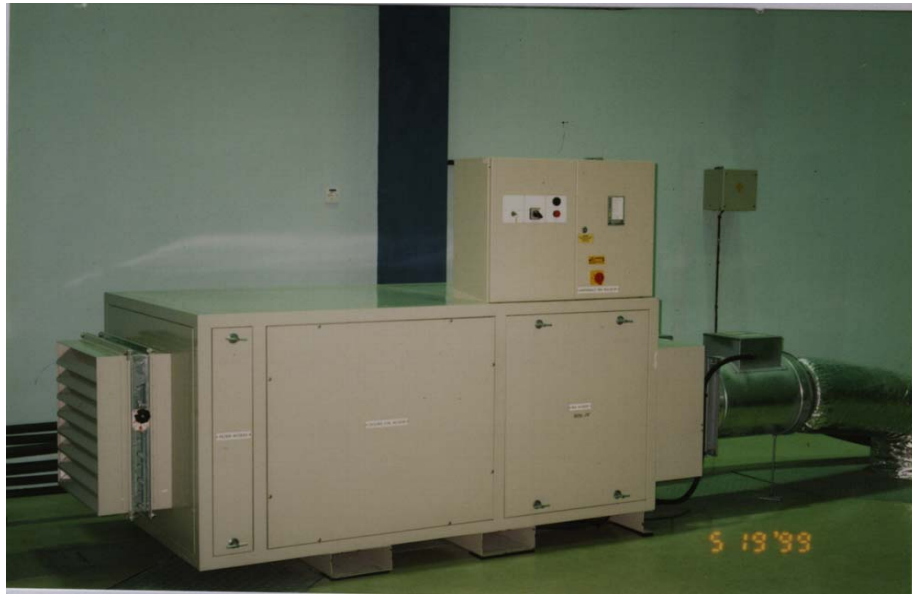
Gambar 13. Air Handling Unit.
